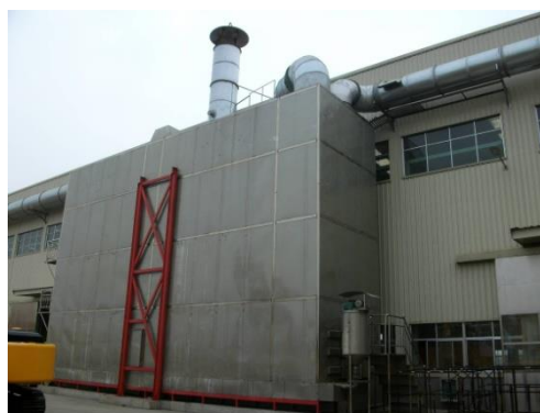
图 2 紫外-生物过滤装置（91800m 3 /h，用于喷涂有机废气治理）
