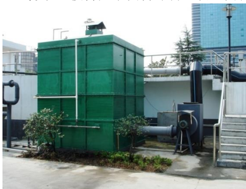
图 1 生物过滤除臭装置（4000m 3 /h，用于污水处理厂恶臭气体治理）
